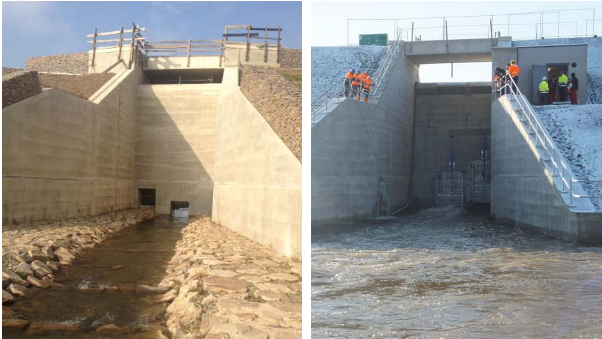
Abbildung 3: Auslaufbauwerk Wasser- und Luftseite
