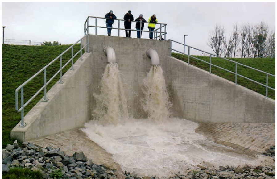
Auslaufbauwerk des Schöpfwerkes beim Probetrieb
