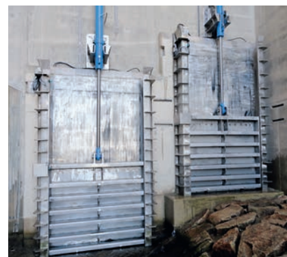
Dichtheitsprüfung der geschlossenen Gleitschütze bei Einstau
