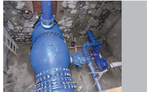
Blick in Schacht S1 mit RKV DN 1000 und KWKA 7,5 kW
