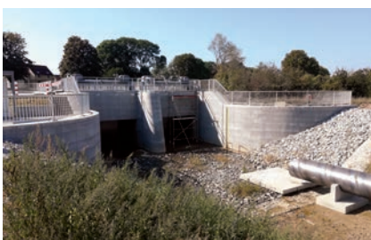
Das Sielbauwerk mit Blickrichtung aus dem Ableitersystem
