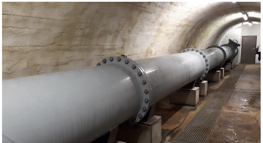
Leitung im rechten Grundablassstollen mit dem Mannloch im Hintergrund
