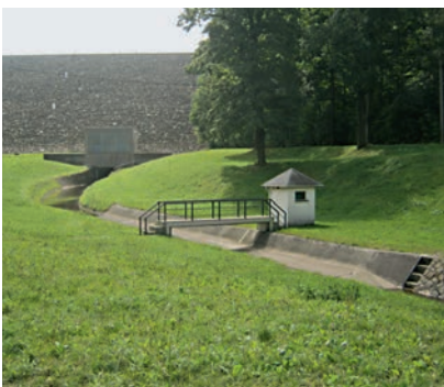
Tosbecken und Ablaufpegel mit Messgerinne
