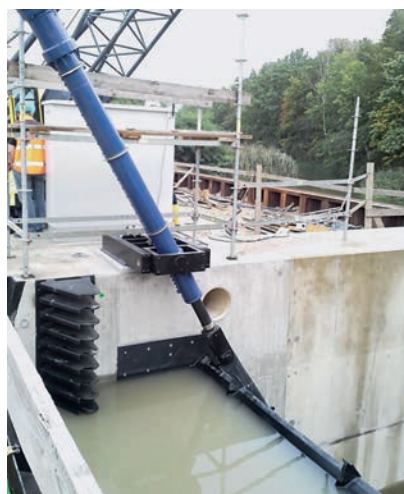
Fischbauchklappe und Elektro-Antrieb mit SPS-Steuerung des oberen Wehres 2. Schleuse Zerben
