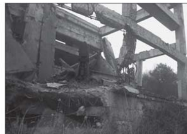
Bestand: im Krieg zerstörtes Rohwasserpumpwerk 2
